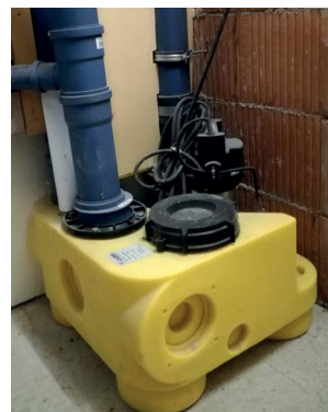
Abbildung 45: Hebeanlage in der Praxis.
