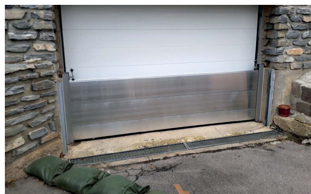
Abbildung 37: Mobiles Dammbalkensystem am Garagentor.
