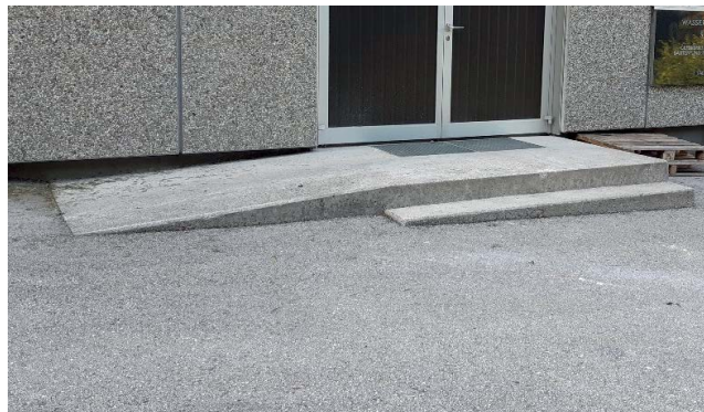
Abbildung 27: Höher gelegter Eingang schützt vor Wassereintritt.
